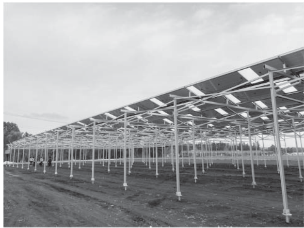
ソーラーシェアリングの発電設備 (NTTスマイルエナジー写真提供)
