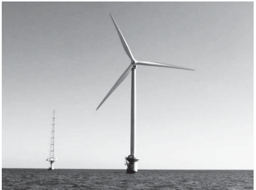
千葉県銚子沖で運営する洋上風力発電設備
