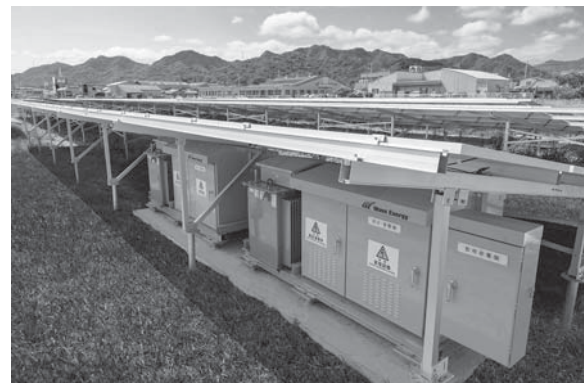
SOLAR SPEC MINI T の設置事例(Wave Energy提供)
