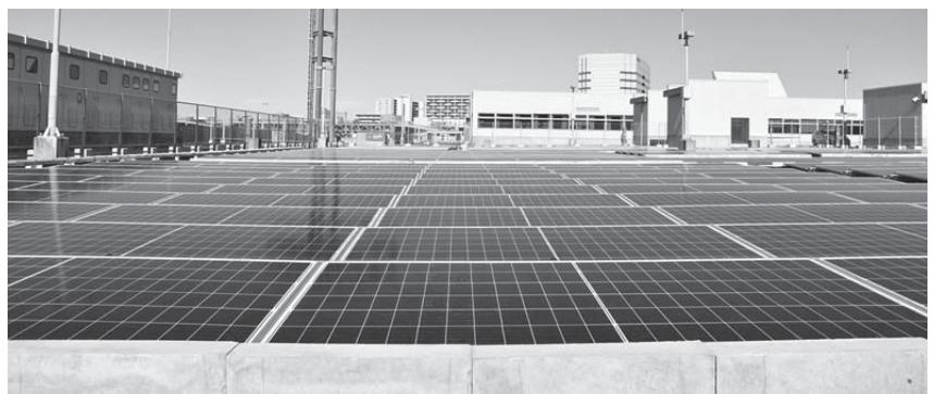
RE100で自家消費の太陽光発電を推進するイケアグループ IKEA Tokyo-Bay 258kW 横浜環境デザイン施工
